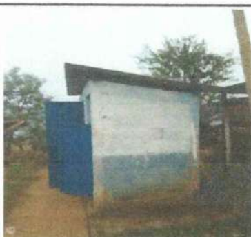
FOTO 3: BAÑOS EN MAL ESTADO
