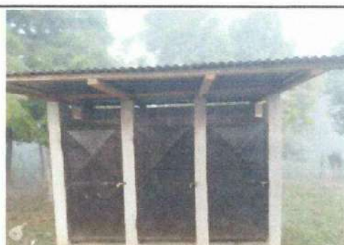
FOTO 4: BAÑOS QUE NECESITAN PINTURA
