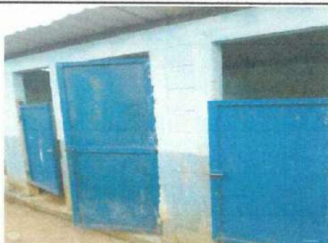
FOTO 1: BAÑOS, QUE NECESITAN CAMBIO DE PINTURA EN PAREDES Y PUERTAS
